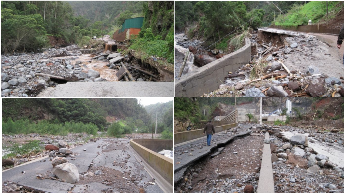
Figura 56 - Danos provocados pelo temporal na Estrada da Fundoa [Fonte: Jorge Freitas – Secretaria Regional do Equipamento Social]
