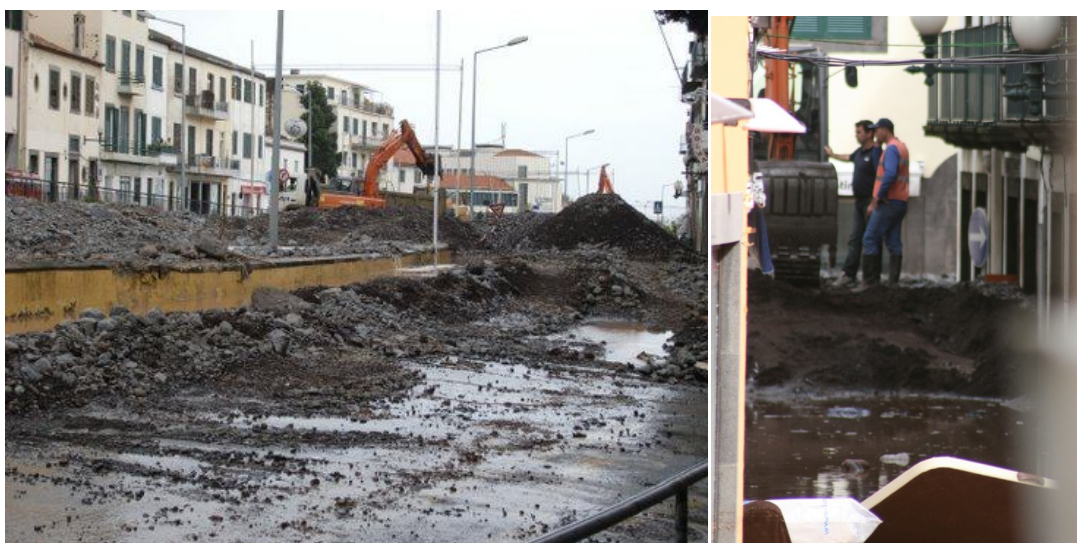
Figura 53 - Material depositado nas ruas circundantes à Ribeira de Santa Luzia [Fonte: Desconhecido]
