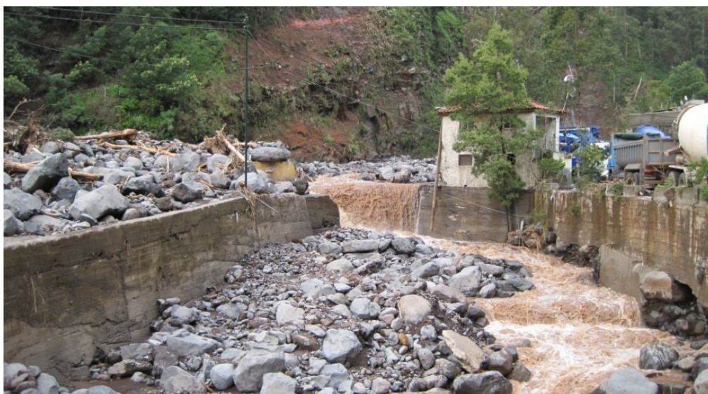
Figura 57 - Ponte destruída na Fundoa [Fonte: Jorge Freitas – Secretaria Regional do Equipamento Social]
