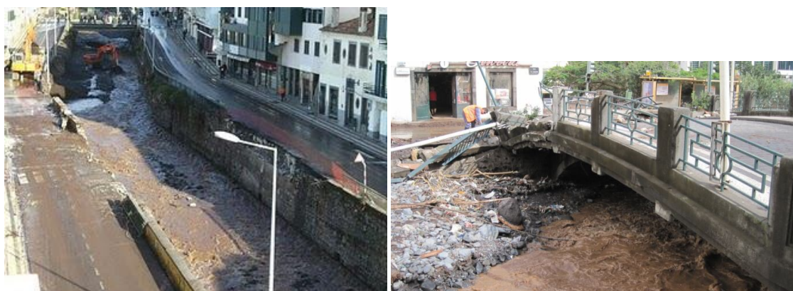
Figura 60 - Os danos nas pontes abaixo da Ponte do Bettencourt e na ponte do Cidrão respectivamente [Fonte: Desconhecido]
