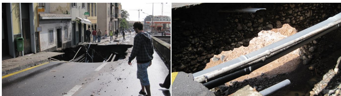
Figura 59 - Rua 31 de Janeiro estragos visíveis após o temporal [Fonte: Jorge Freitas – Secretaria Regional do Equipamento Social]
