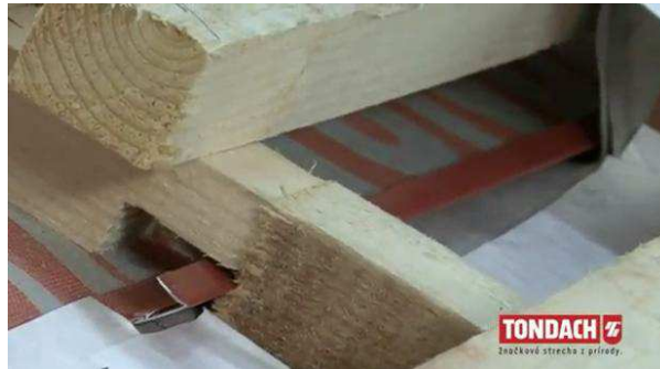
Obr. Odvodňovací žlab z plechu nad komínem [39]
