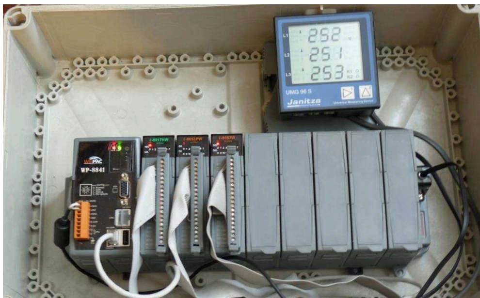
Obrázek 7.1 Fotografie realizace celého zařízení.
