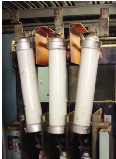
Obrázek 18: Vysokonapět'ové pojistky (6 kV, 100 A) chránící kompenzaci pásového vozu
