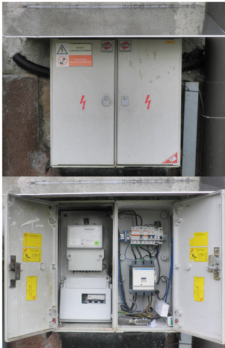
Obrázek 9 Fotodokumentace rozvaděče RVO-1
