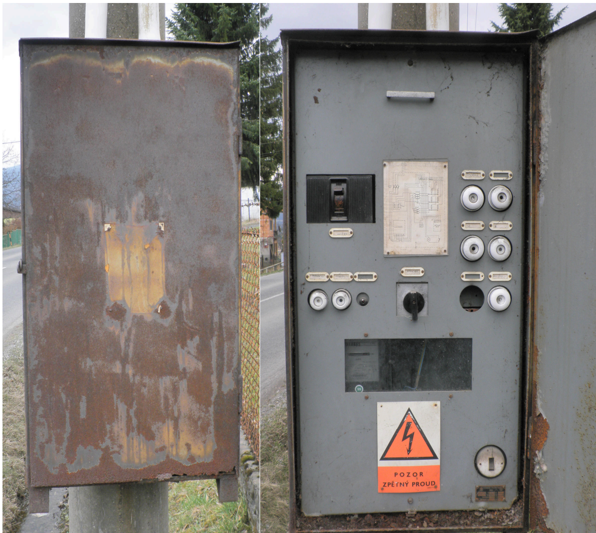
Obrázek 10 Fotodokumentace rozvaděče RVO-2
