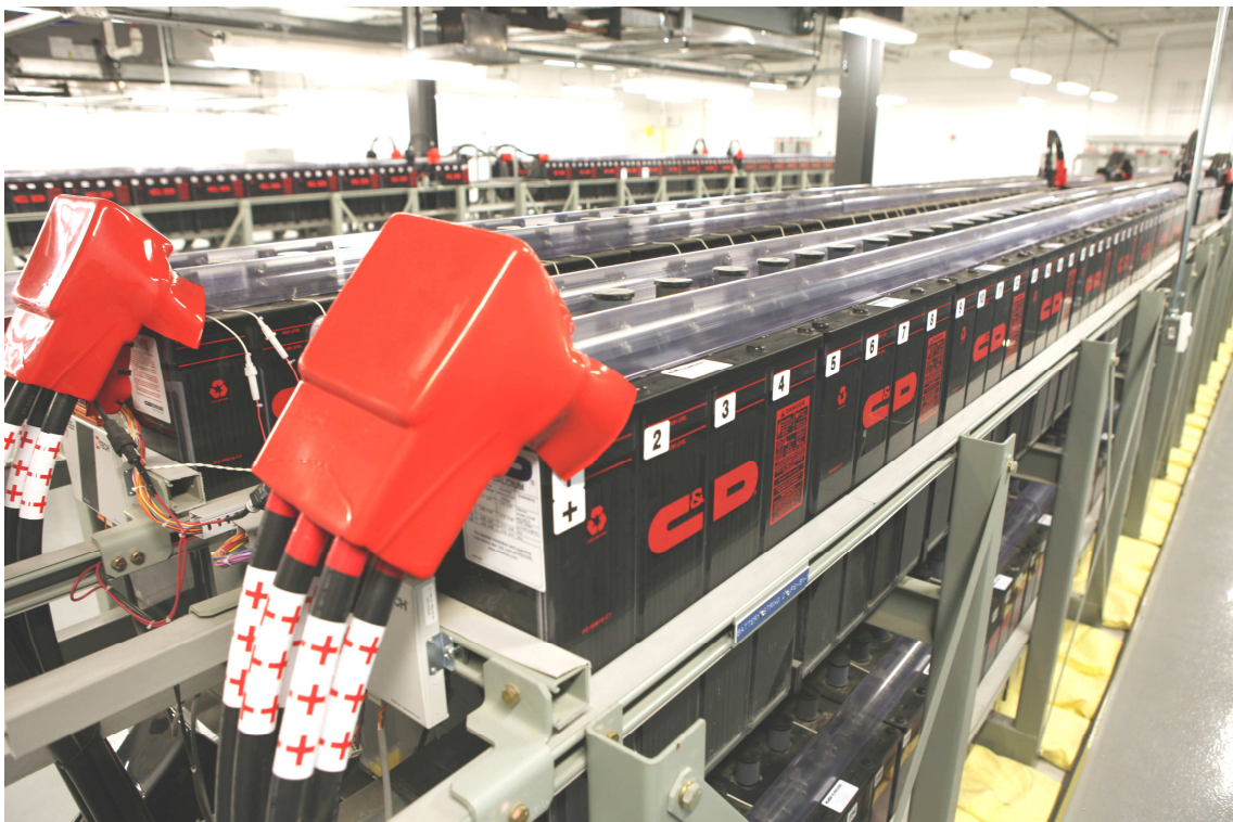
Obr. 1 Staniční akumulátorová baterie [13]
