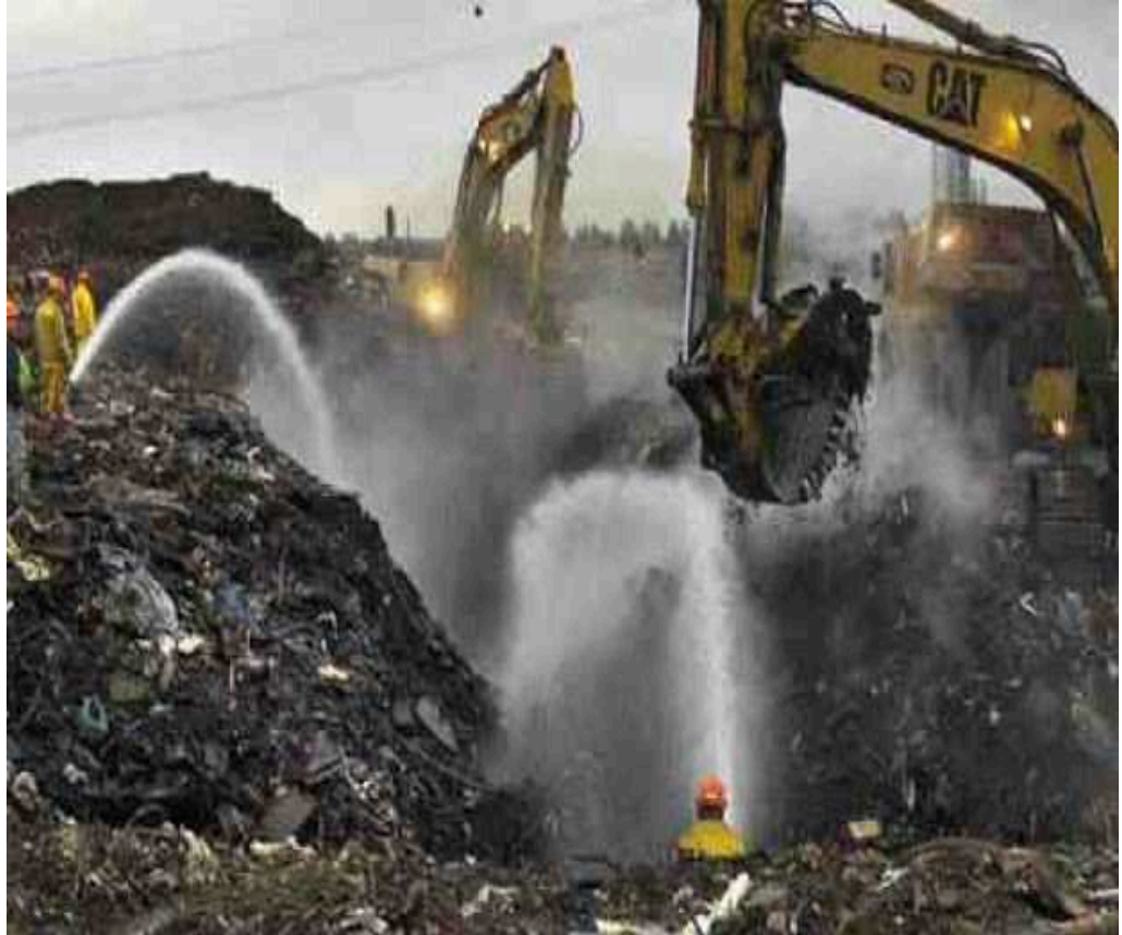
Obrázek č.14: Likvidace požáru pomocí těžké techniky na skládce Delta Shake a Shingle Abake v roce 1999. [23]
