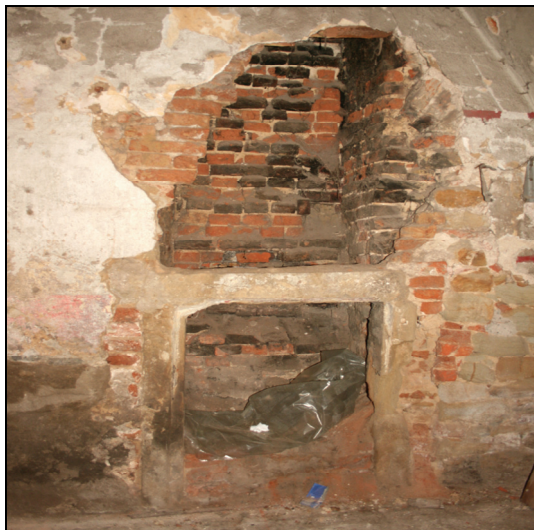
Obr. 9: Příkládací portál ve východní zdi průjezdu 101 pro obsluhu topeniště v m. č. 114, foto, 2011
