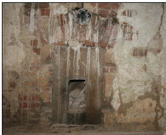
Obr. 10: Příkládací ostění v chodbě 208 východního křídla v patře upravené na vymetací otvor novodobého topeniště, foto, 2011
