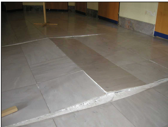
Obr. 1: Deformace podlahy a dlažby
