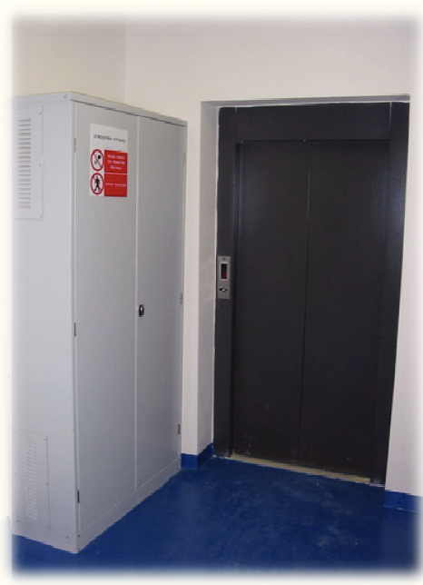
Obrázek č.5 – Skříň výtahové strojovny
