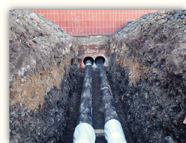
Obrázek č.6 – Přívod primárního předizolovaného potrubí do objektu
