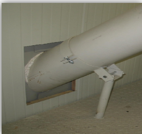
Obr. č. 32 Prostup šnek. dopr. opláštěním a jeho podpora
