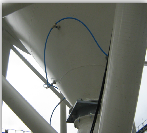
Obr. č. 36 Rozvod vzduchu k čeřícím dýzám
