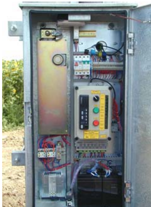
obr.3.16. skříň dálkově ovládaného úsekového odpínače
