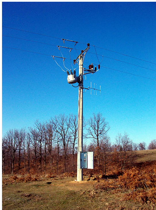
obr.3.14. dálkově ovládaný recloser GVR 27
