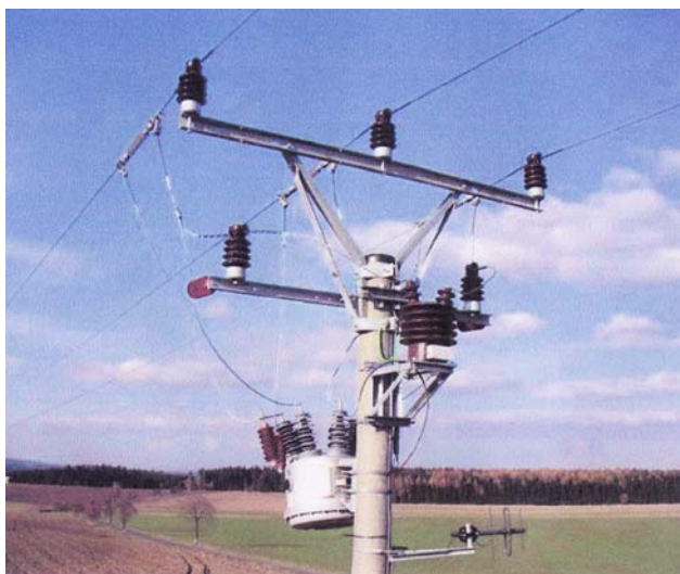
obr.3.19. venkovní vypínač GVR recloser
