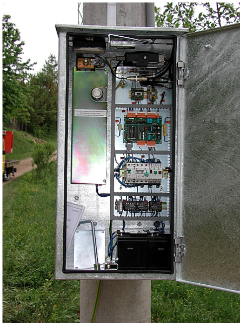
obr.3.13. výzbroj skříňe dálkově ovládaného úsečníku
