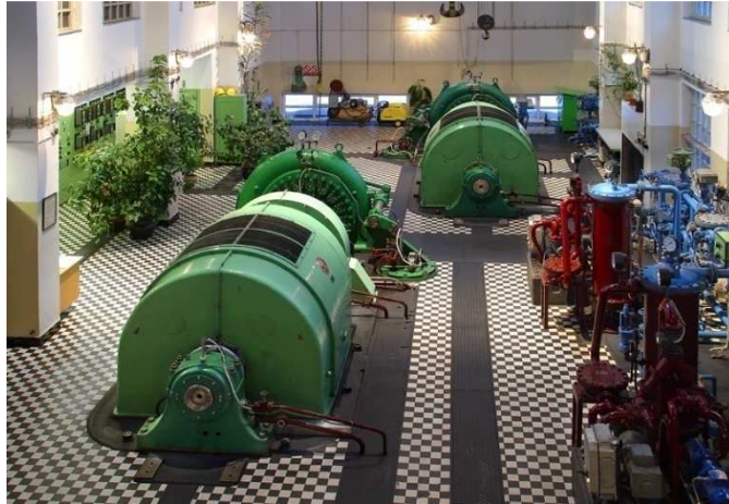
Obrázek 3.4 Strojovna malé vodní elektrárny
