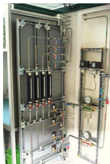
Obrázek 21: Rozvodná a redukční stanice provozních plynů s příslušenstvím
