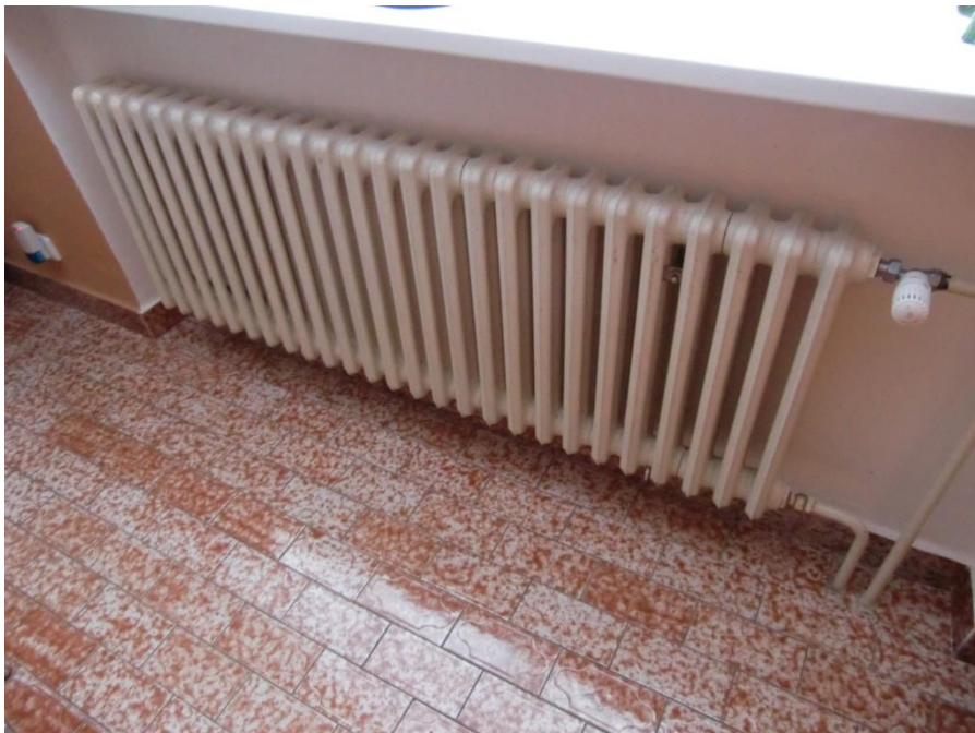
Obr. č. 6.8 Litinové radiátory v domě osazené TRV
