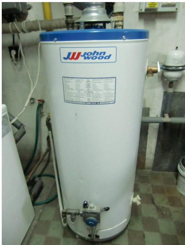
Obr. č. 6.5 Plynový stacionární kotel na ohřev teplé vody JohnWood JW302SNA o výkonu 8,5 kW a kapacitou 114 litrů
