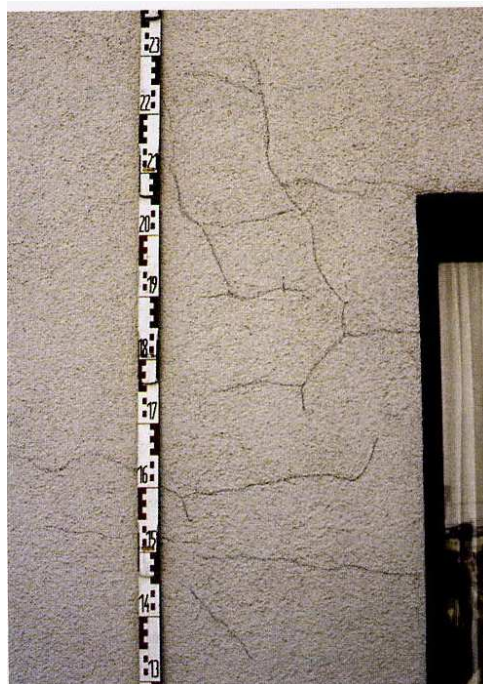
obr č. 3.2 - síťové trhliny s rozvětvením ve tvaru Y (tzv. trhliny způsobené smršťováním) – porušení způsobené chybami v omítce [2]
