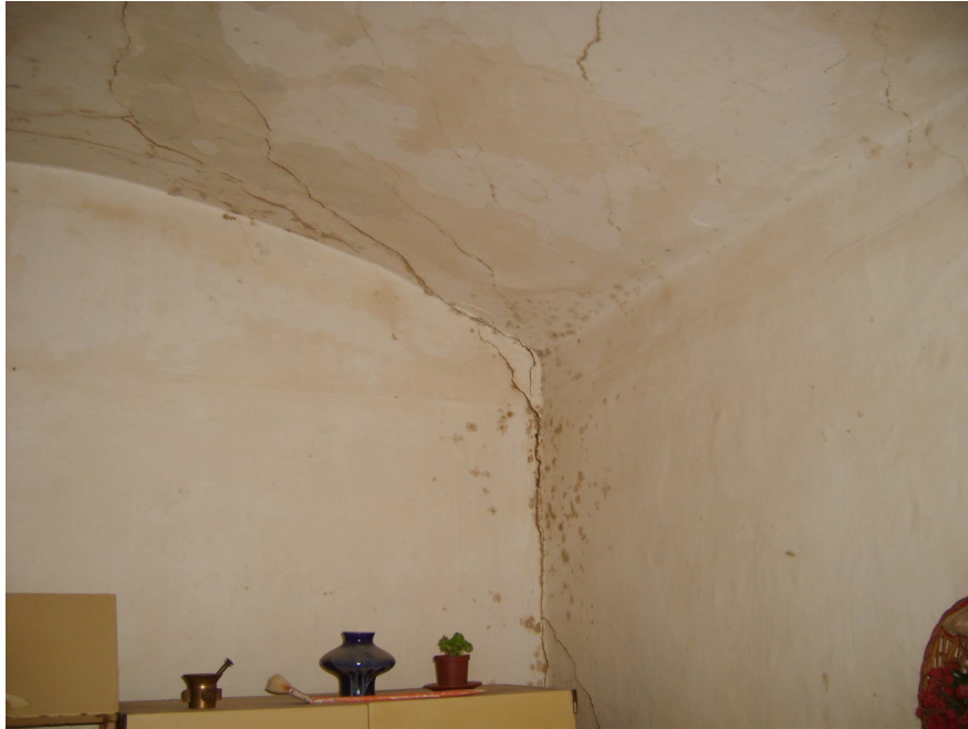
obr. č. 3.4 – závažnější trhliny v omítce
