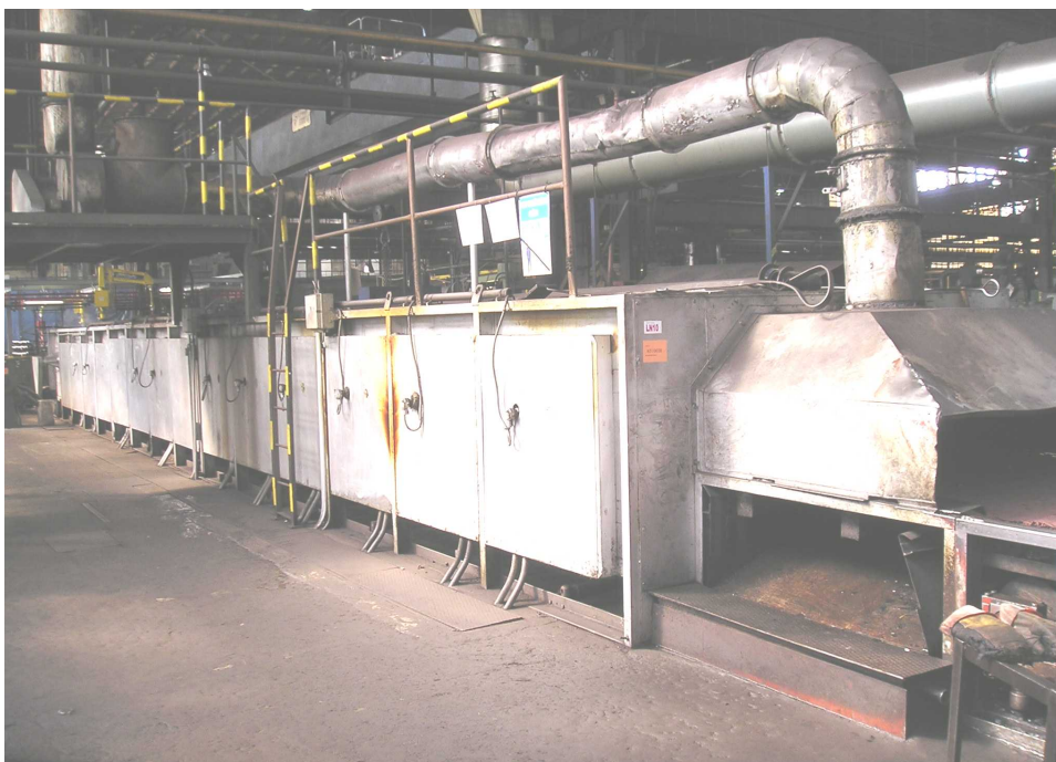
Obr. 13 Popouštěcí elektrická pec – pohled od kalícího dopravníku
