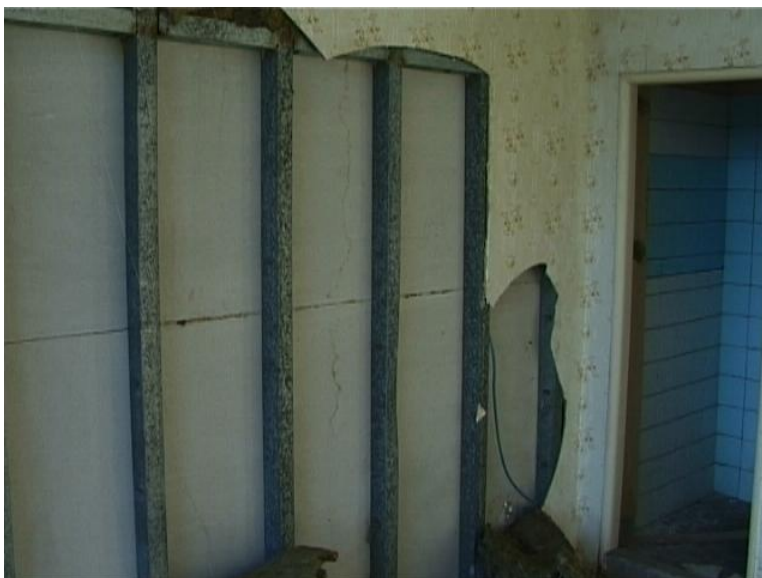
Obr.7: Nosná konstrukce zničených příček
