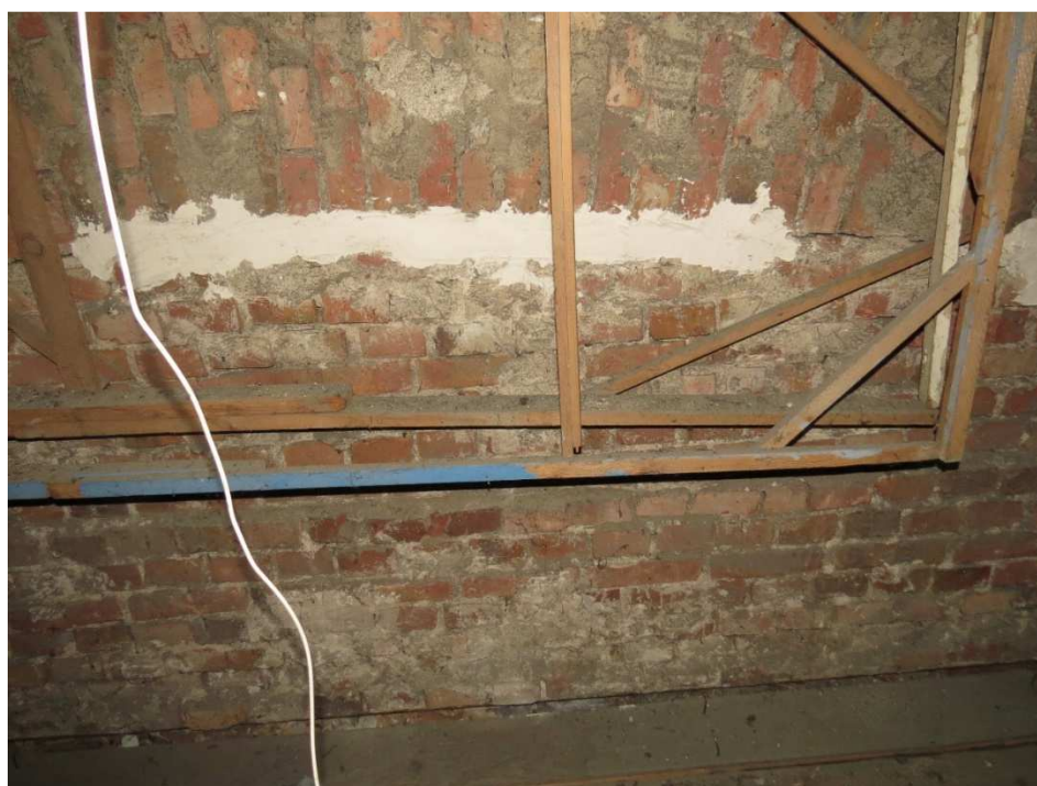
Rys. 8. Nienaruszone plomby gipsowe w miejscu pęknięcia (Autor, 2016)
