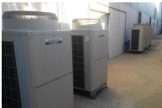
Figura 3. Unidades exteriores de producción. (Fuente: Oficina técnica empresa)
