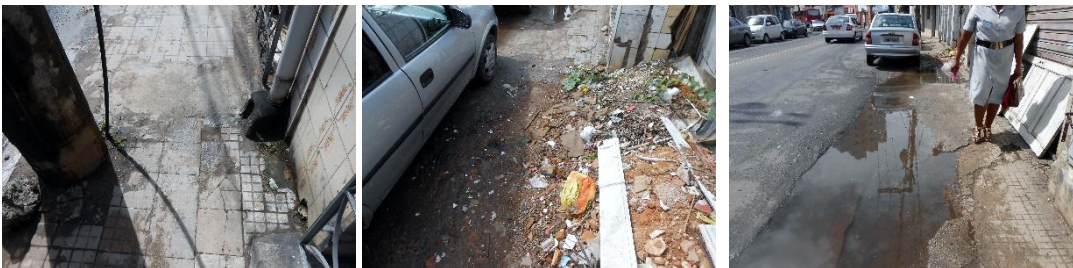
Figura 20: Vista da condição do piso da calçada na Rota 4 (Barbosa, 2015)
