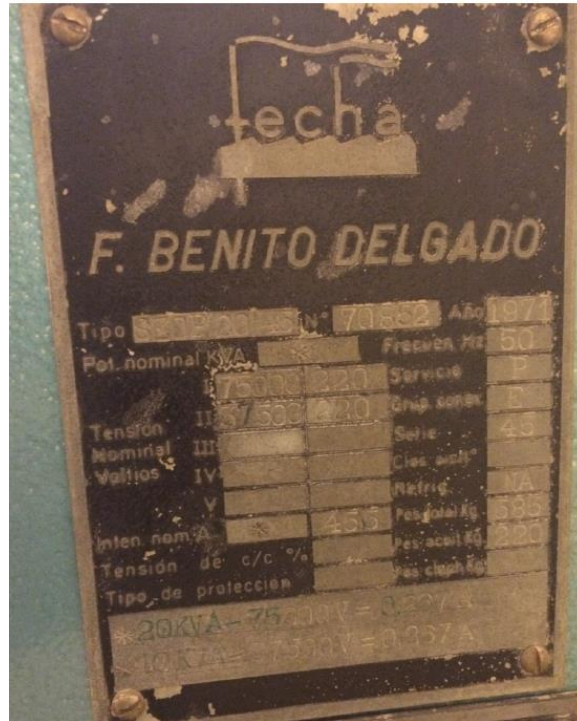
Figura 6-7 Placa de característiques del Transformador d'alta tensió.
