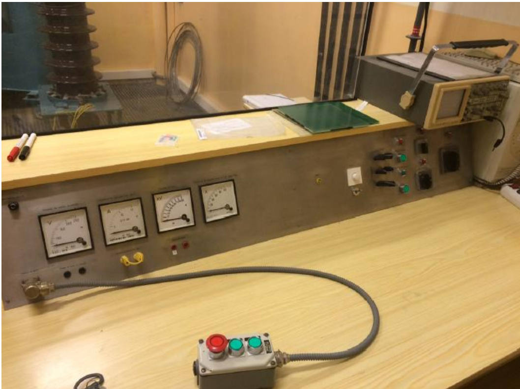
Figura 6-15 Panell de control.
