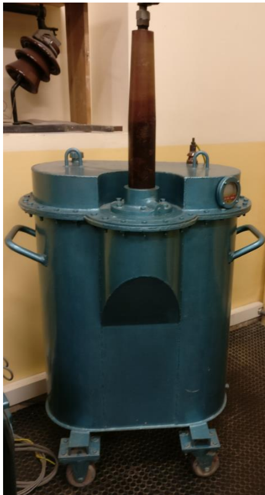
Figura 6-6 Transformador d'alta tensió de 220 / 75000 V.
