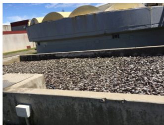
Figura II.7. Desodorizante del gas de línea de fangos
