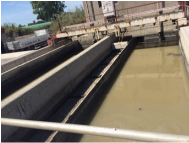
Figura II.1. Pretratamiento del agua residual
