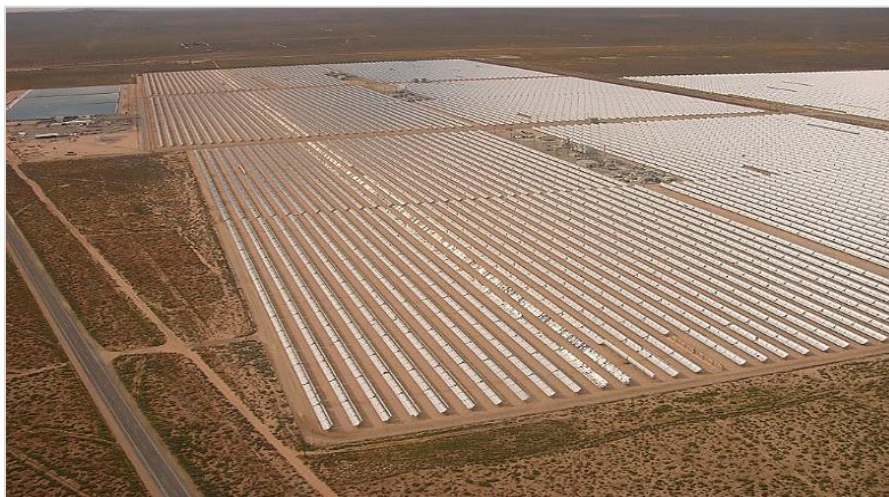
Figura 5.18 Campo solar de Colectores Cilíndrico Parabólicos. [2]
