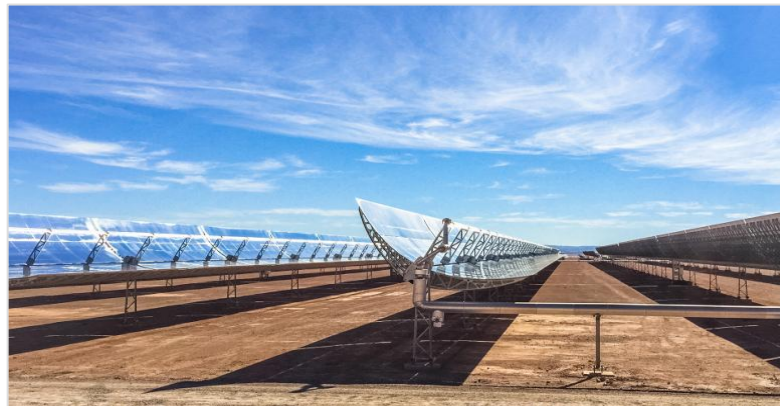
Figura 5.5 Colectores Cilíndrico Parabólicos. [41]
