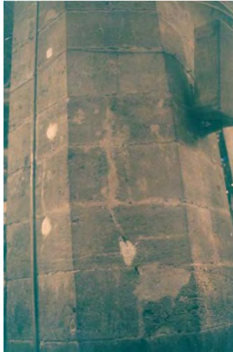
Figura 7.8 Fisura vertical en la base de un pilar
