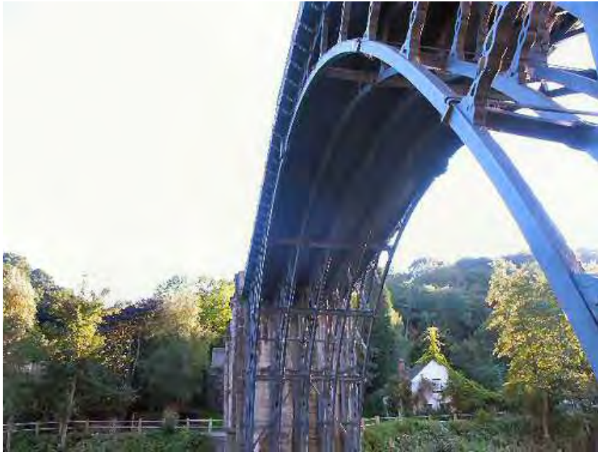
Figura 1.2. Vista inferior del primer puente metálico de la Historia. ( http://www.virtual-shropshire.co.uk )
