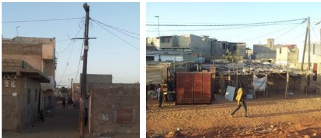
Fig.6: Pals elèctrics que sustenten amb precarietat els cables que subministren l'energia a les llars.
