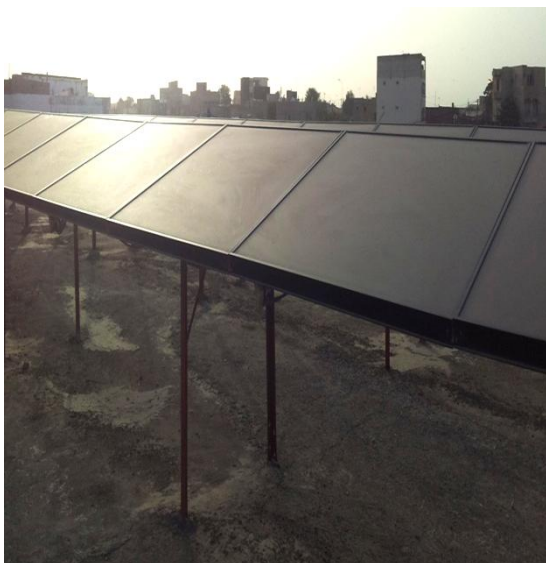
Fig.74: Panells solar fotovoltaics fora d'ús, situats al terrat de l'edifici 1.
