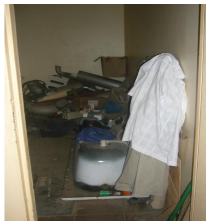
Fig.6: Magatzem per a les bombes d'extracció d'aigua residual.
