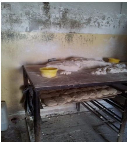
Fig.6: Falta de manteniment de parets i paviment.
