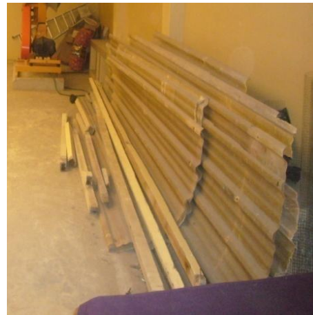
Fig.28: Acumulació de material en mal estat i sense ús a la sala 2.
