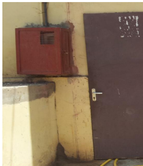
Fig.35: Caixa general de protecció de l'edifici 2.
