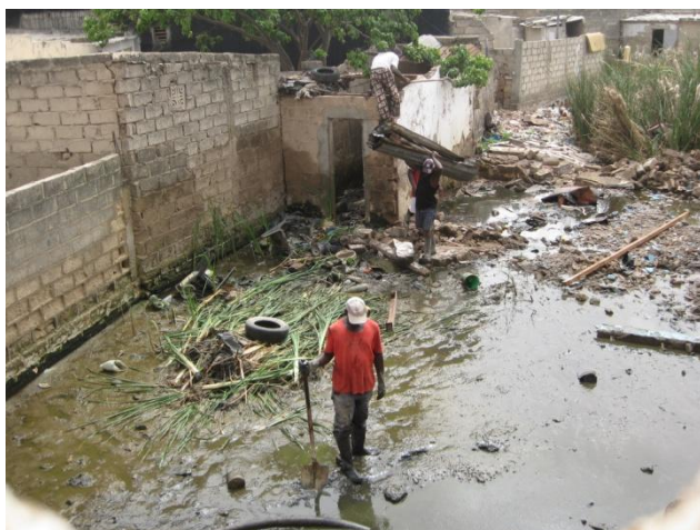
Fig.3: Neteja del terreny on s'acumulen les deixalles i es concentra tota l'aigua residuals provinents de les fosses sèptiques. Font: responsable del Centre.
