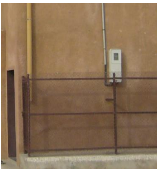
Fig.36: Caixa general de protecció de l'edifici 1.
