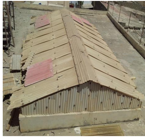
Fig.26: Perspectiva exterior de la coberta de la claraboia de la sala 2. Destaca un mal estat de conservació.
