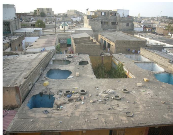
Fig.10: Cases que presenten sostres enderrocats amb acumulacions de pneumàtics i diversitat de deixalles.
