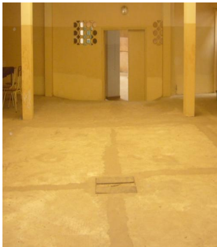
Fig.2: Paviment revestit de ciment que presenta una superfície irregular.
