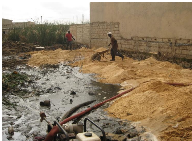
Fig.4: Bombejament de les aigües residuals i acumulació de terres per ascendir el nivell del sòl respecte el nivell freàtic. Font: responsable del Centre.
