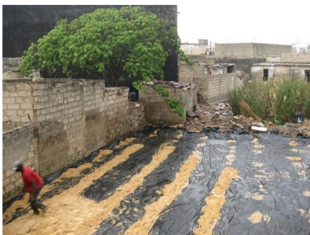
Fig.5: Incorporació d'un recobriment aïllant de plàstic en el sòl, per evitar humitats i inundacions en el paviment de edifici. Font: responsable del Centre.
