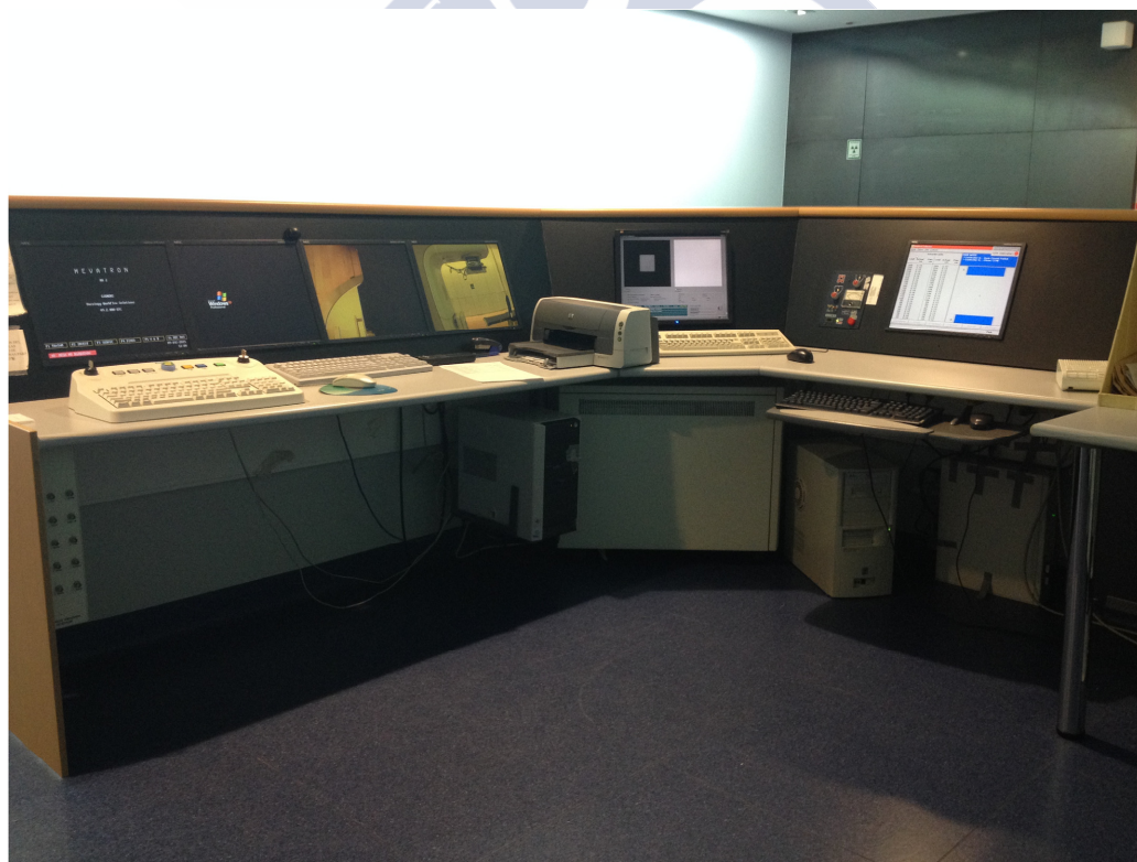
Figura 22. Sala de control monitorizada.
