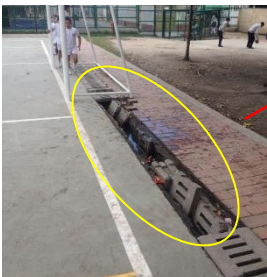
Ilustración 14 Rejillas en mal estado despiden malos olores, afecta mucho (9)
