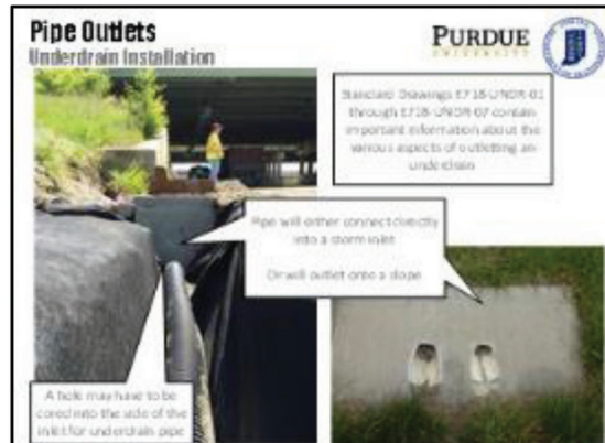
(d) Outletting pipes for drainage
