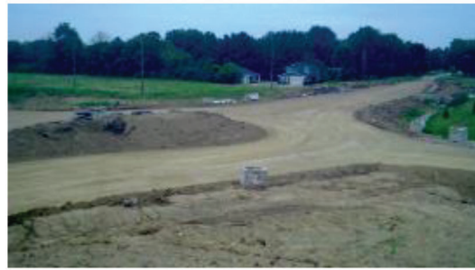
(d) 7/16/15 – Drainage structures
