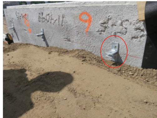
(d) Improper fix of broken connectors
