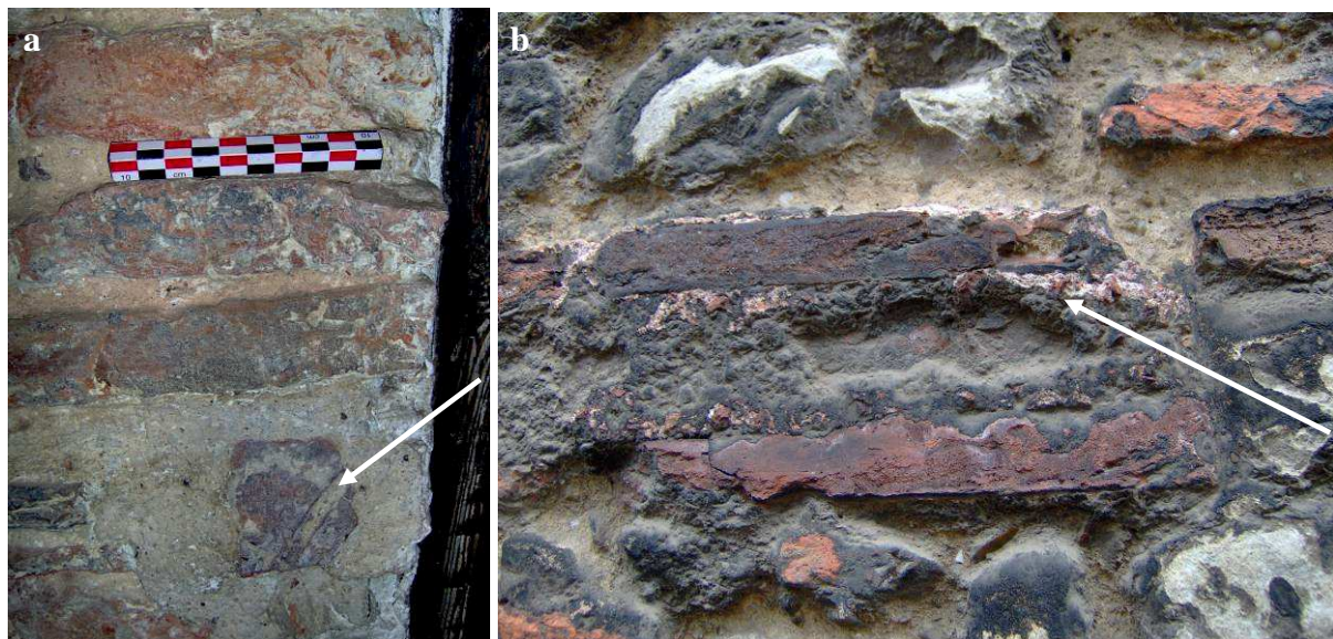
Figures 150 a & b: traces de digitation sur un fragment de terre cuite utilisé dans la maçonnerie (a) et traces de mortier de tuileau rose adhérent à la surface de briques (b).
