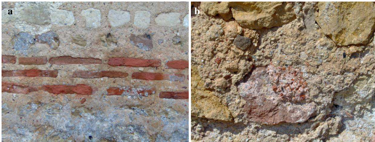
Figures 103 a & b : Briques du le mur nord du chevet : on observe une hétérogénéité dans les couleurs et dimensions des briques ; mortier de tuileau rose adhérent à la surface d'une tuile incrustée dans le mur.
