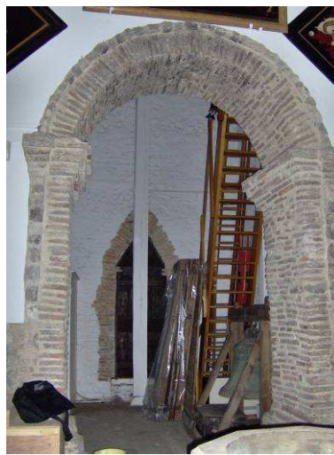
Figure 149: intérieur de la tour : arc oriental (en premier plan) et porte occidentale (en arrière plan).
