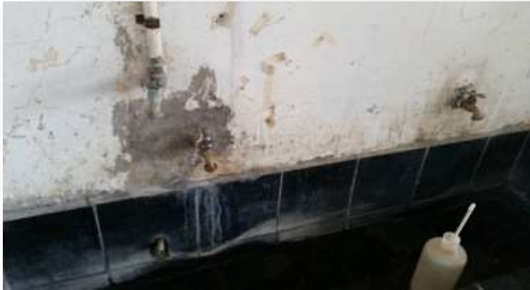
Falta de mantenimiento y limpieza a lavamanos
