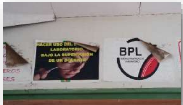
Señal semi despegada
