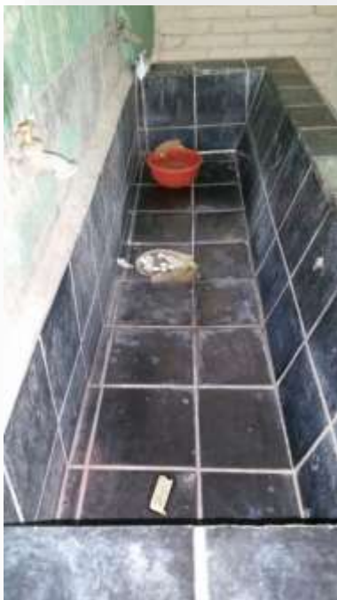
Falta de mantenimiento y limpieza a lavamanos
