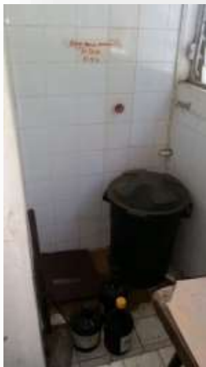
Almacén de recipientes de químicos en las duchas
