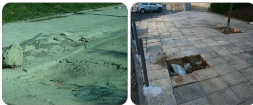
Fig. 44a, 44b, 44c, 44d - Mau estado de conservação de edifícios e zonas do espaço público Fonte: Relatório do Plano de Ação 21 (Agenda 21 Local)
