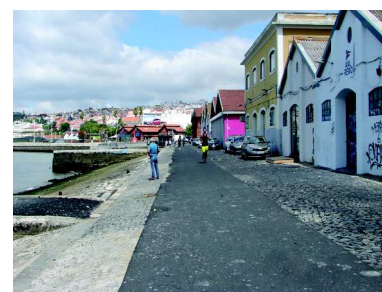
FIG. 96. Cais do Gás, pavimento em mau estado, fotografia da autora, 2016.
