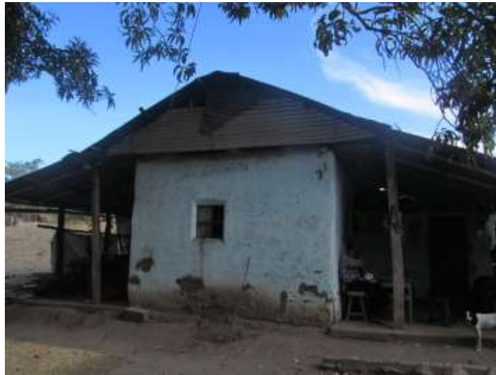
Figura 162. Deficiencia geométrica en alzado
