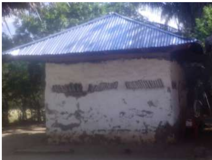
Figura 168. Humedad por goteo. Vivienda Ramírez
