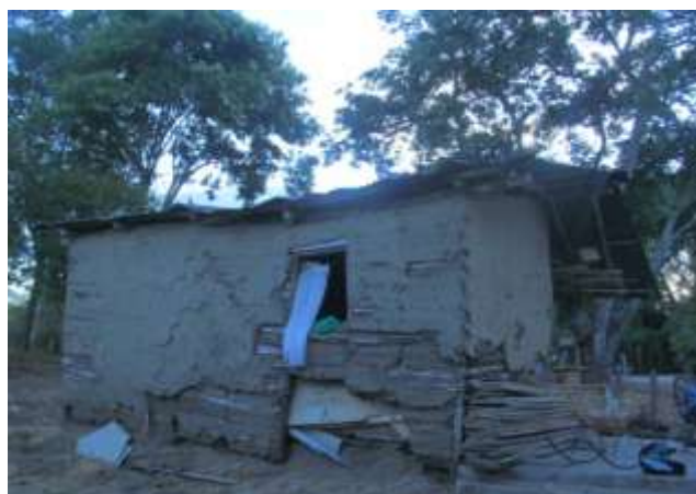
Figura 163. Ausencia de cimentación-asentamiento diferencial.
