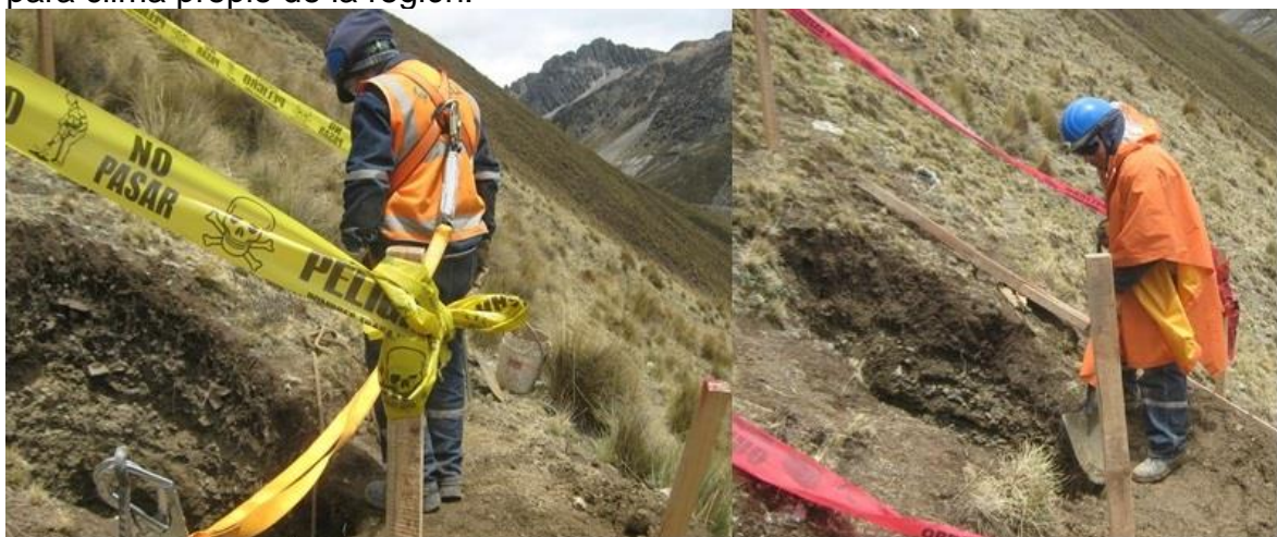
Figura n.º 25, Izquierda: trabajador con arnés para evitar caídas; Derecha: EPP para clima propio de la región.
