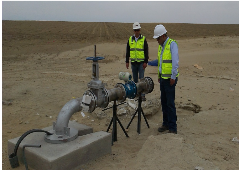
FIGURA 25. Pozo culminado para bombear agua para riego de terrenos de cultivo Fuente: Drillex International Perú SAC
