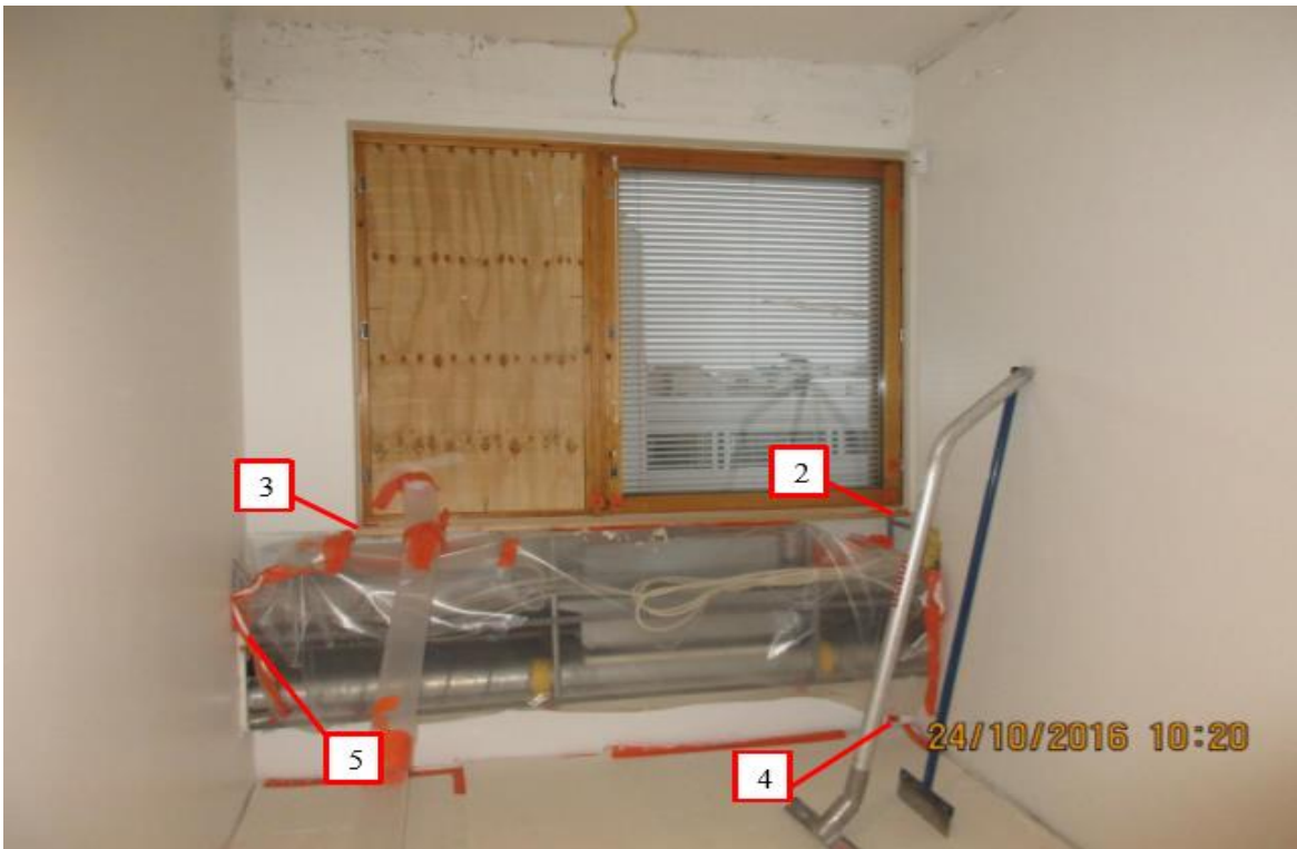
KUVA 10. Vuotokohdat osoitettu esimerkkikohteessa
