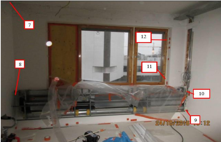
KUVA 9. Vuotokohdat esimerkkikohteessa esitetty seinässä oransseilla teipeillä
