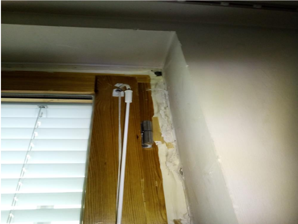
KUVA 7. Ikkunan höyrynsulkumassauksessa reikiä esimerkikohteessa
