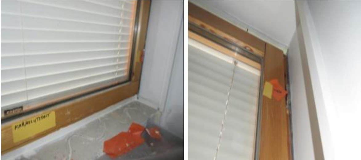
KUVA 11. Vuotokohtat esimerkkikohteen ikkunakarmeissa
