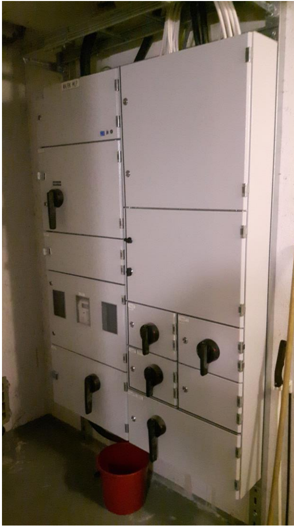
Kuva 13. Esimerkkikohteeseen asennettu uusi nousu- / ryhmäkeskus.
