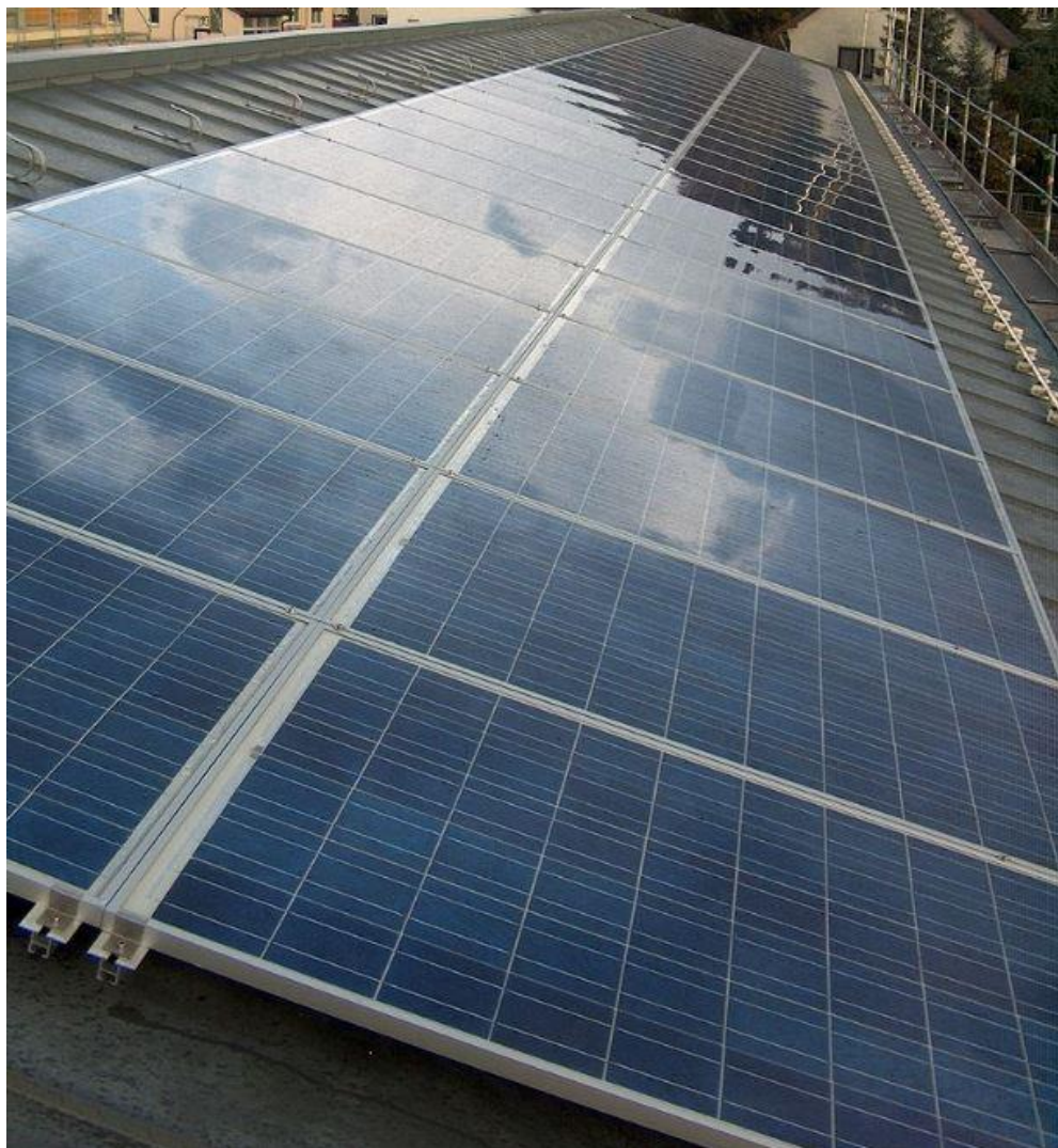
KUVA 17. Aurinkoenergiapaneelisto asennettuna kiskostoon (wikipedia 2005)
