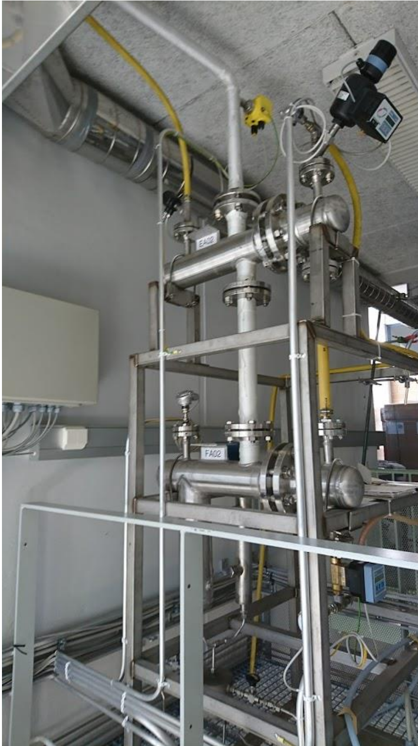
Kuva 17. Ylimenon lauhdutin, paineensäätöyksikkö ja ylimenotuotteen varastosäiliö
