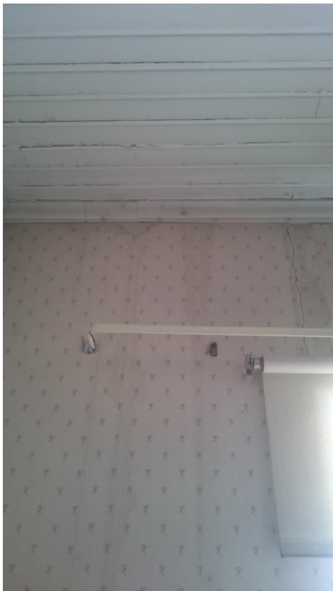
Kuva 14. Sama vesivahinko alakerrasta.
