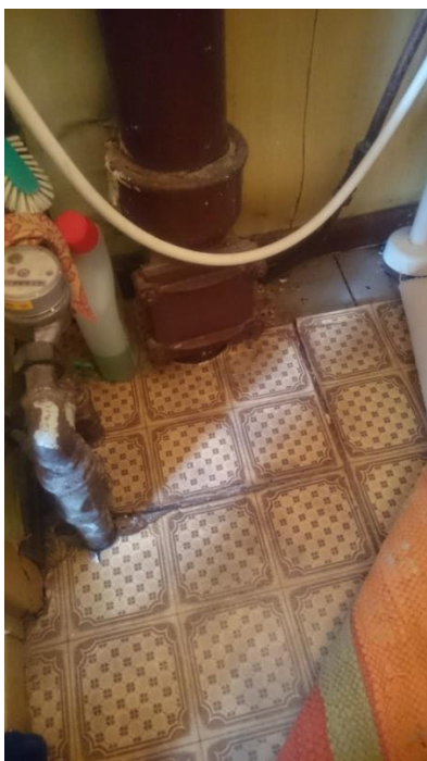
Kuva 12. WC-tilan lattia kupruilee.
