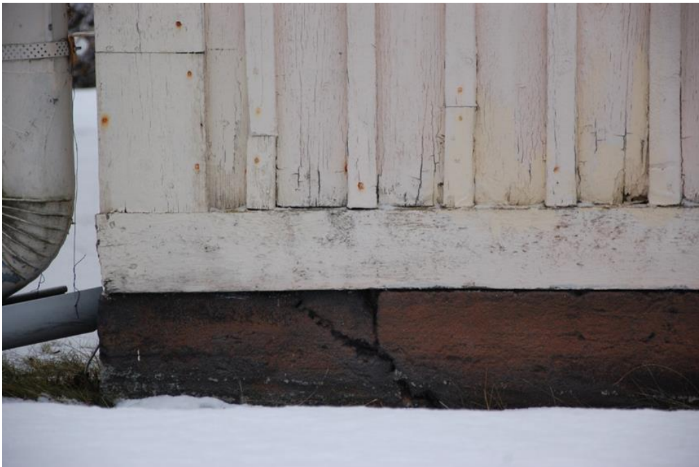
Kuva 4. Perusmuurin halkeilua eteläpäädyssä.
