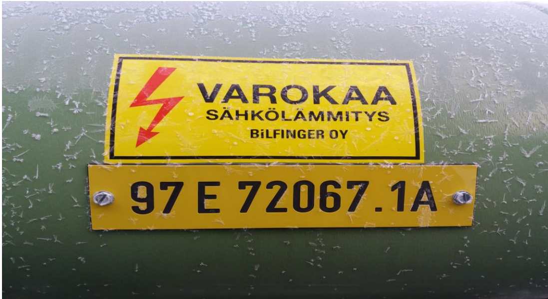
Kuva 11. Esimerkki varoitustarrasta sekä sähkölämmityspiirin tunnuksesta [13.]
