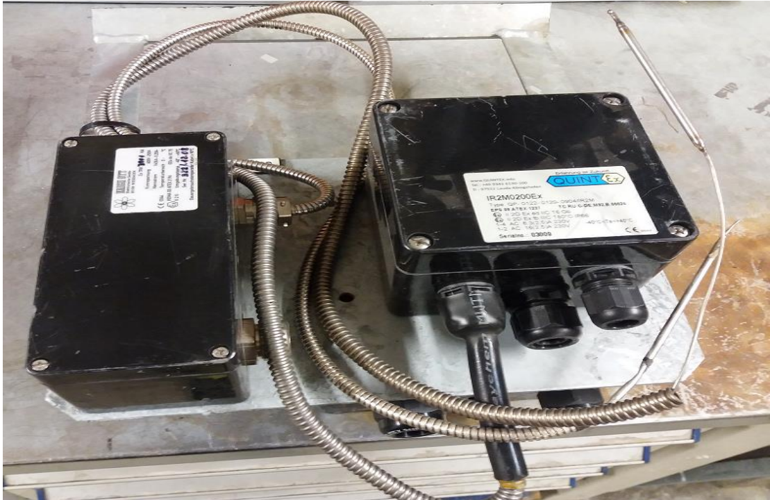
Kuva 6. Termostaatteja rasialevyssä kiinni [13.]
