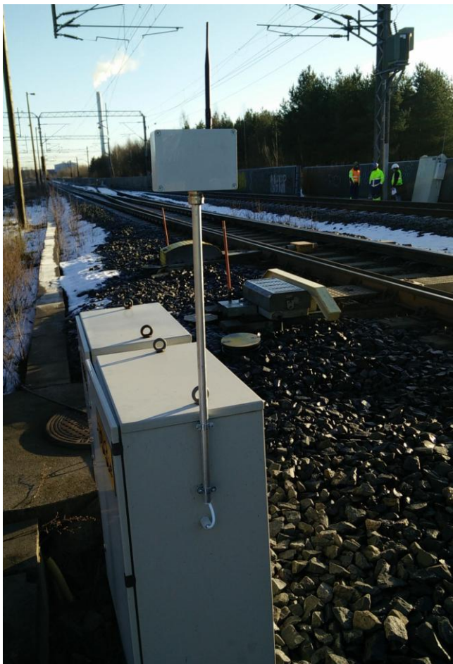
Kuva 20. Reititin asennettuna erotusmuuntajakeskukselle.
