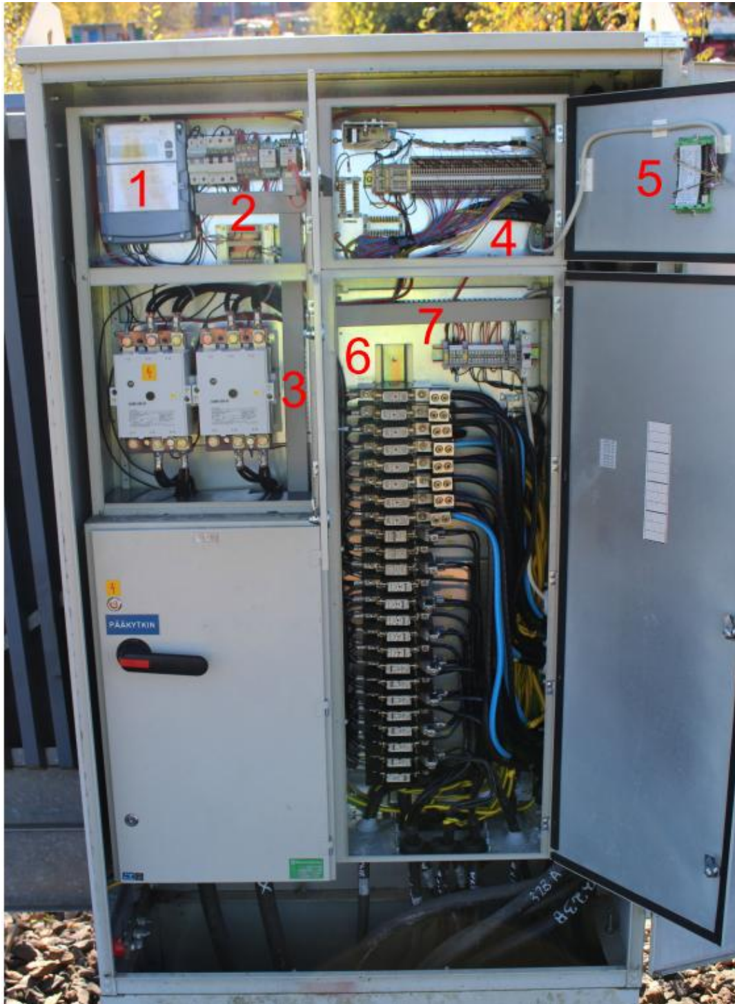
Kuva 7. Vaihteenlämmityskeskuksen rakenne ja komponentit, energianmittaus 1, ohjaussakkeet ja -releitä 2, pääkontaktorit 3, heikkovirtaohjaukset 4, hälytyskeskus 5, kaapelilähdöt erotusmuuntajakeskuksille 6, kaukokäytön ohjauskaapeli ja riviliittimet 7.
