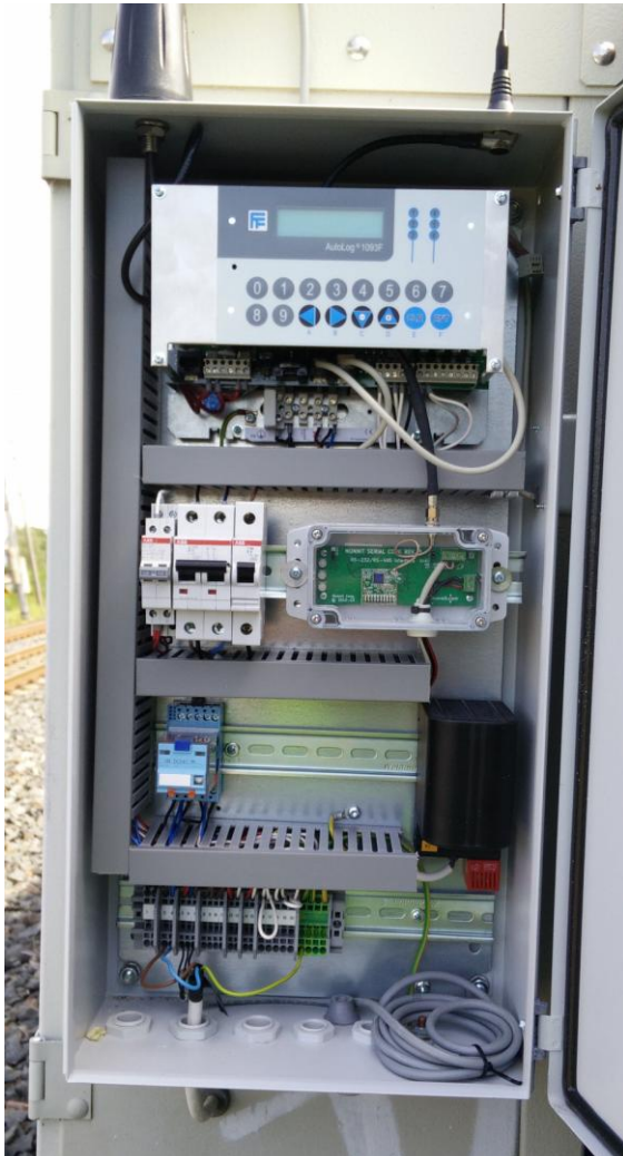
Kuva 14. Automaatiokeskus asennettuna vaihteenlämmityskeskuksen kylkeen.
