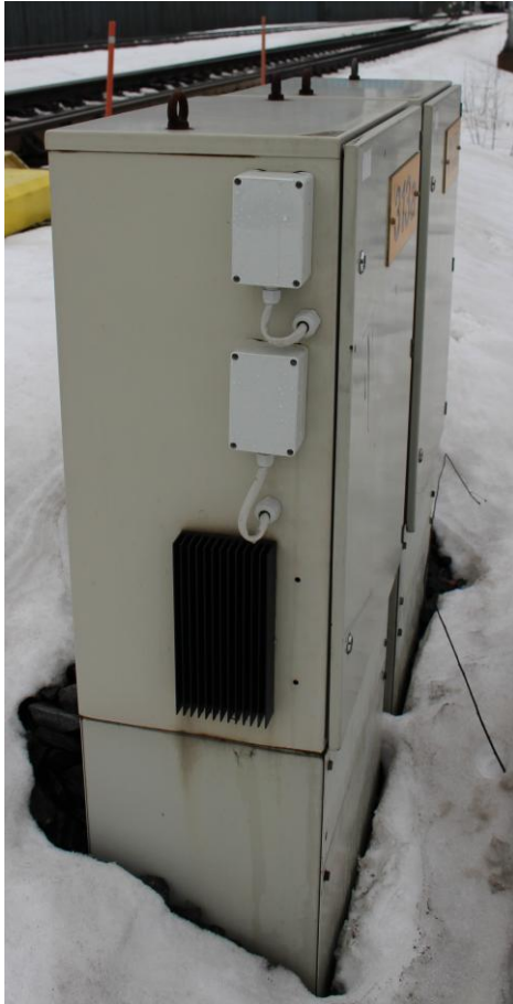
Kuva 15. Lähetin ja vastaanotin asennettuna erotusmuuntajakeskukseen.
