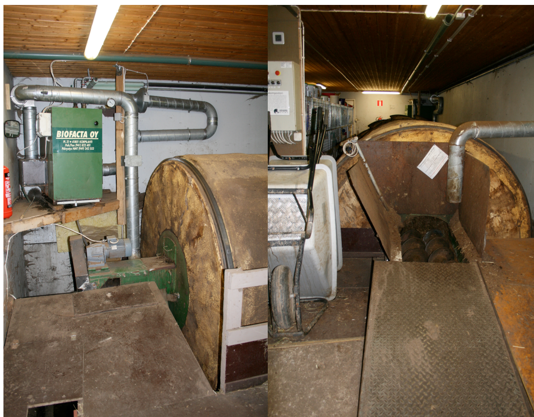
Kuva 3. Niihama Riding Oy:n Biofacta Oy:n rumpukompostori Tampereella. (Kuvat: Maija Mäihäniemi)
