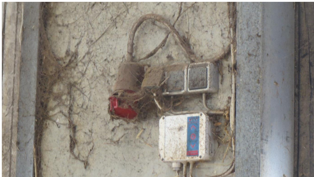
Kuva 4. Maatilan toimintaympäristössä lämpötilan vaihtelut, pöly, kosteus ja eläinten kontaktit asettavat suuret vaatimukset asennusten toteuttamiselle ja laitteiden rakennevaatimuksille.
