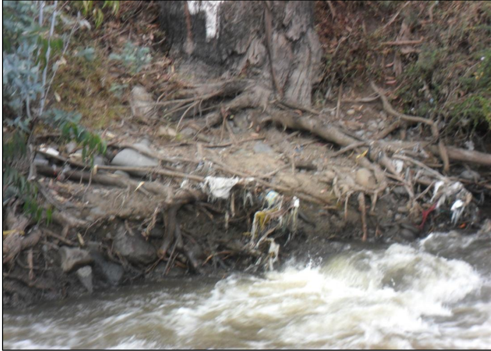
Erosión del suelo por el crecimiento del caudal del Río Ambato
