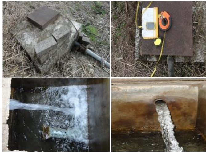
Figura 24. Cámara rompe-presión N° 3.
