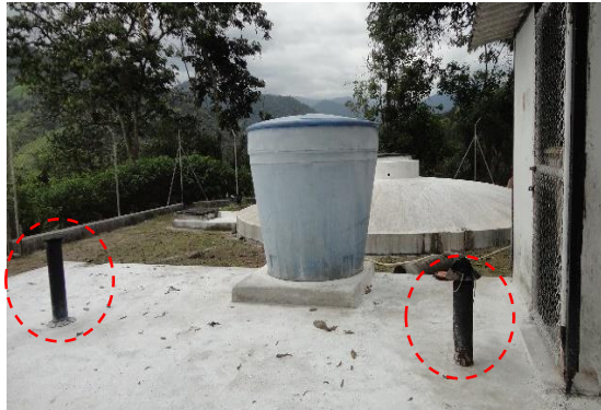
Figura 27. Tubería de ventilación.
