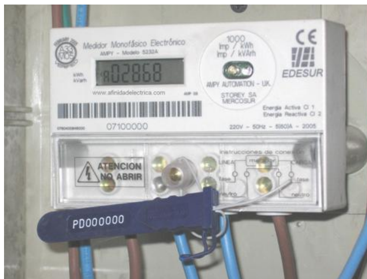
Figura 1.4. Contador de energía electrónico [7].
