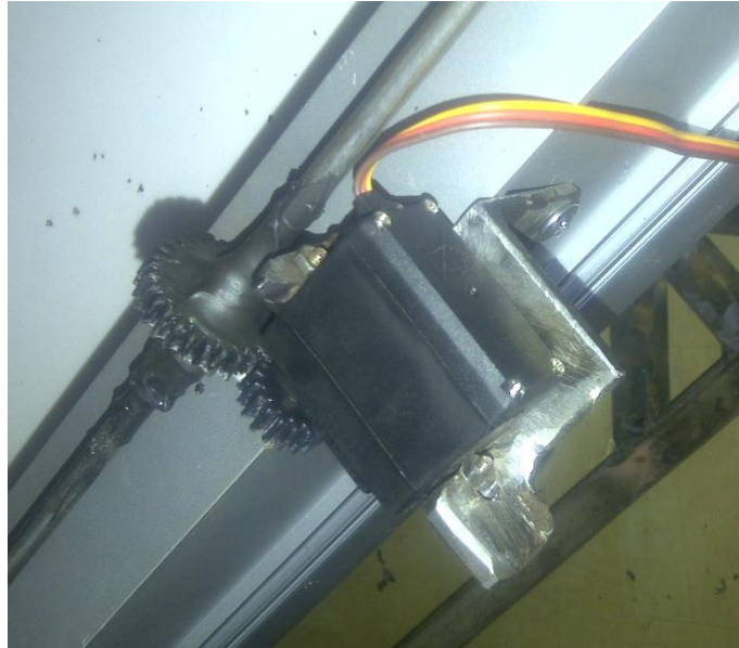
Figura 54. Colocación de piñón en el eje y motor en la estructura del sistema
