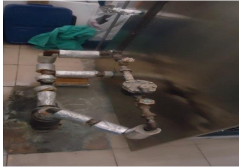
Figura 2.7 Sistema de trampeo de condensado en autoclave de subcentral de esterilización
