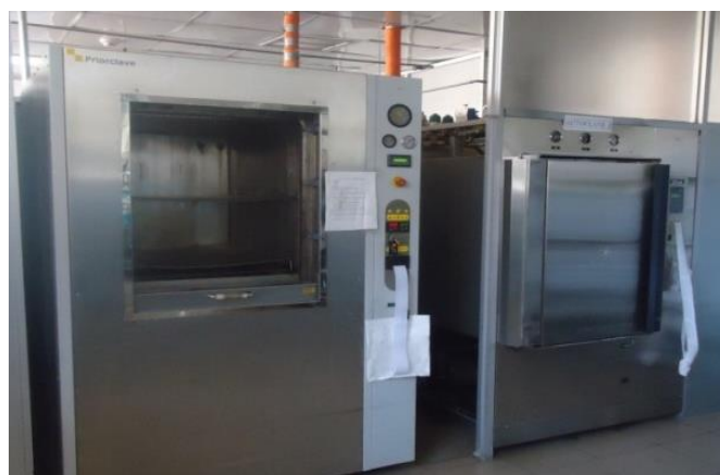
Figura 2.5 Autoclaves en subcentral de esterilización
